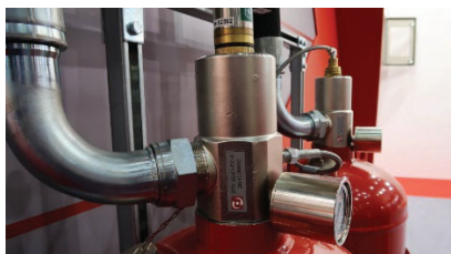
СИСТЕМЫ ГПТ С ПРИМЕНЕНИЕМ ХЛАДОНА 125, ХЛАДОНА 227ea, ДВУОКСИ УГЛЕРОДА (CO 2 )
